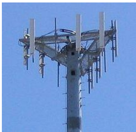
Рис. 5.1. Антенны трех базовых станций на мачте
