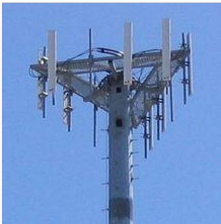
Рис.3.1. Антенны трех базовых станций на мачте
