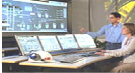
Рис. 7.3 — Автоматизированное рабочее место энергетика
