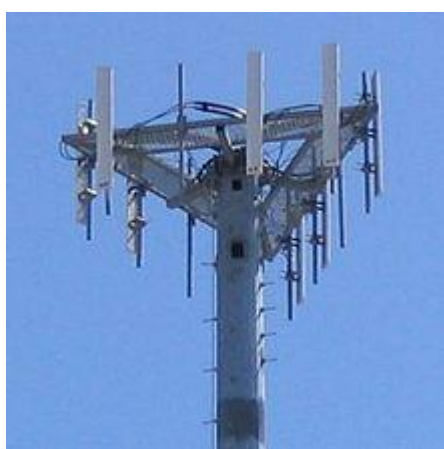
Рис.7.1. Антенны трех базовых станций на мачте
