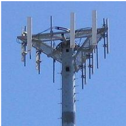
Рис.5.1. Антенны трех базовых станций на мачте
