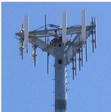
Рис.3.1. Антенны трех базовых станций на мачте
