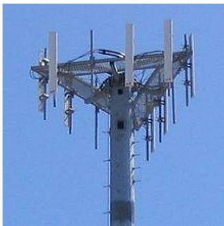
Рис.5.1. Антенны трех базовых станций на мачте
