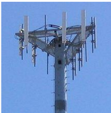
Рис.5.1. Антенны трех базовых станций на мачте
