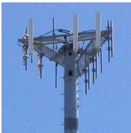
Рис.7.1. Антенны трех базовых станций на мачте
