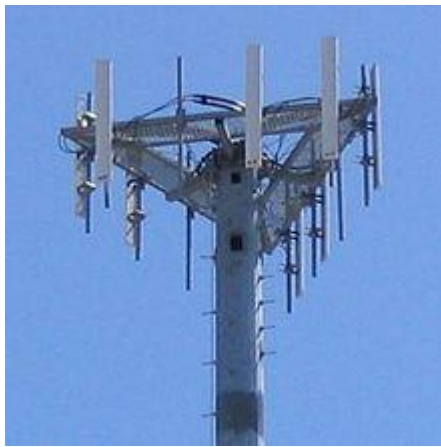
Рис.7.1. Антенны трех базовых станций на мачте
