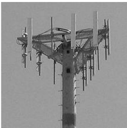
Рис.1. Антенны трех базовых станций на мачте
